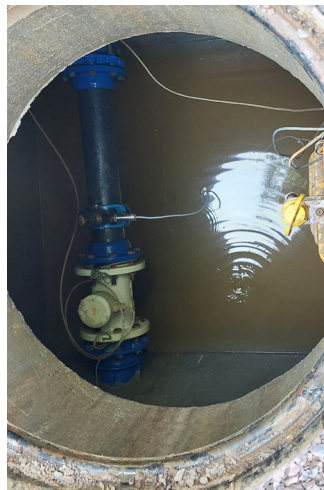
Compteur de sectorisation
