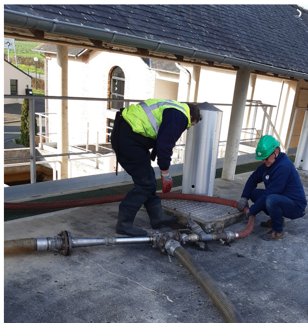
Opération de renouvellement des charbons actifs à l'usine de Chauvon.
